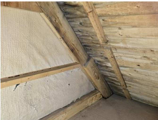
Nockvind: Mikrobiell påväxt/missfärgningar vid gavel mot väst.
