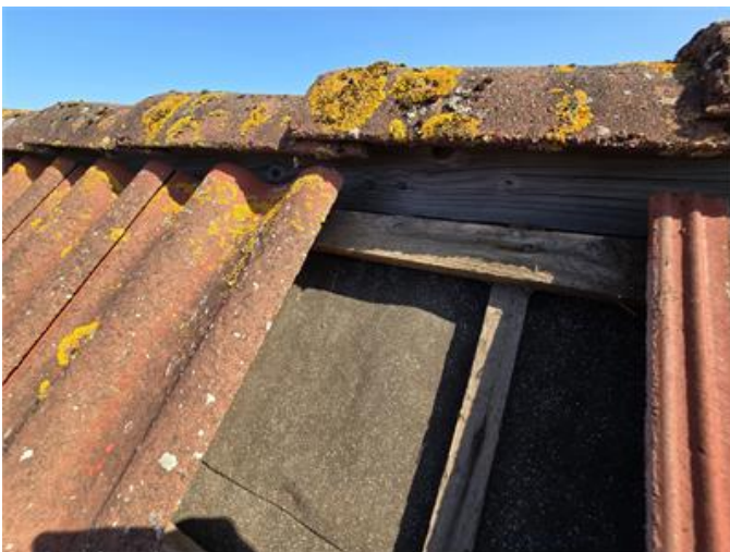
Tak: Stickprovskontroll under pannor, otätt vidnock samt torr/skör underlagspapp.
