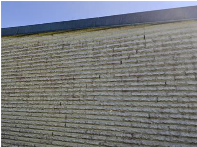
Fasad garagegavel, sprickor förekommer.
