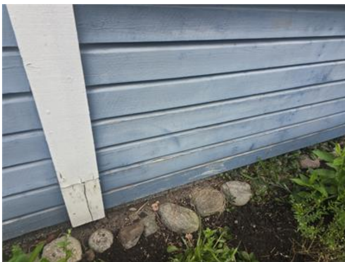
Målning/underhållsbehov och lokal rötskada, fasad.
