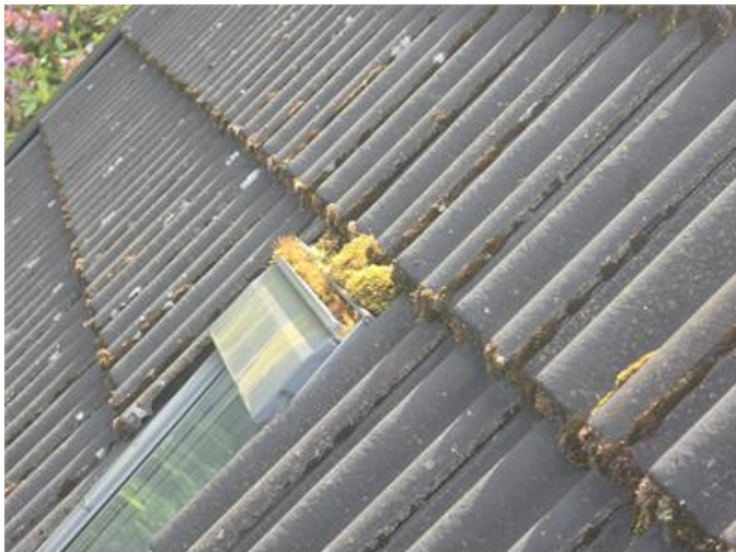
Exempelbild, mosspåväxt på tak och ovan takfönster.
