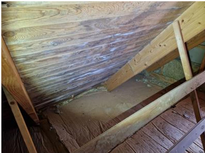
Vind: Mikrobiell påväxt förekommer
