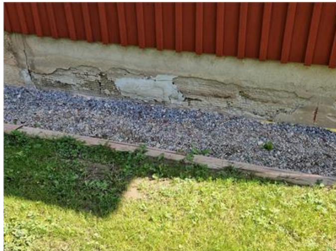
Sockel: Putssläpp och rörelsesprickor förekommer.
