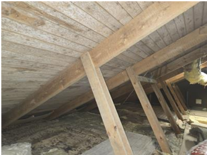
Exempel på del av underlagstak och mikrobiell påväxt.
