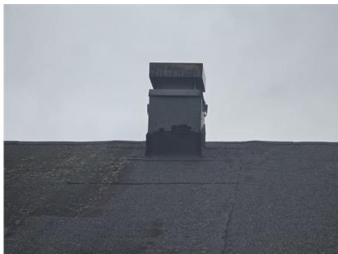
Papp uppvikt på utsidan av plåthuv, med tiden kan läckage uppstå mellan plåt och papp.
