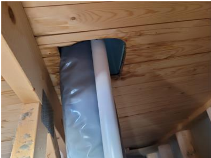
Fuktfläckar på underlagstak
