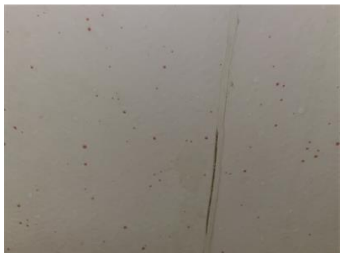
Otättheter förekommer i ytskiktsskarvar i dusch/WC.
