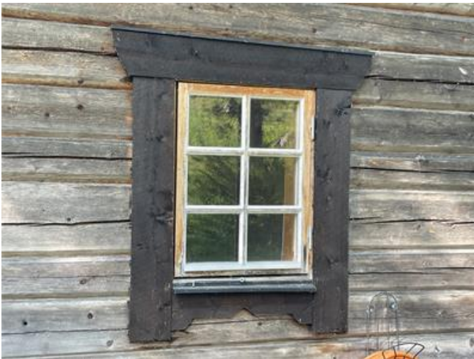
Fönster har målnings- och underhållsbehov.
