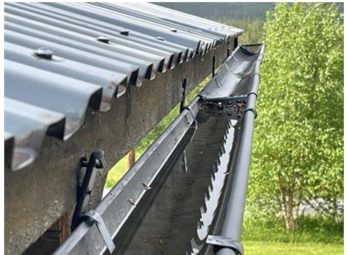
Hängränorna har bristfällig lutning och är i behov av rensning.
