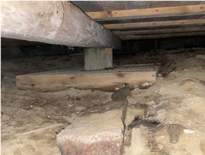
Formvirke med mikrobiell påväxt och röta förekommer på marken i krypgrunden.
