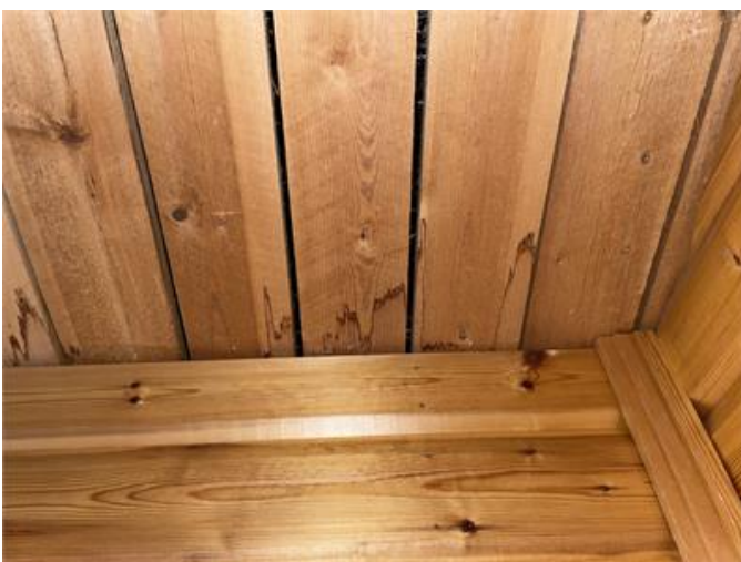
Fuktfläckar/missfärgning förekommer lokalt på tak och vägg i flera utrymmen invändigt.
