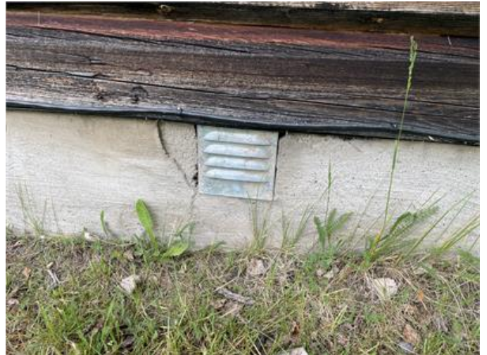
Sprickor och putssläpp förekommer i normal omfattning på sockel.
