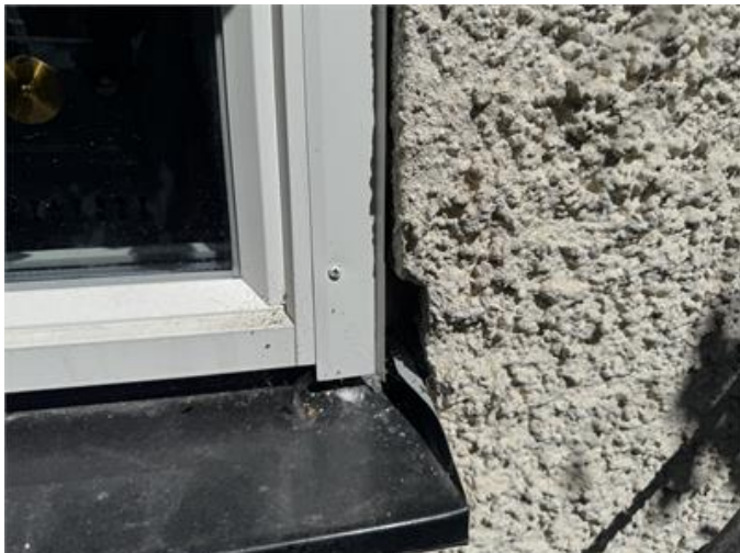
Otättheter i fasadputs mot fönster.
