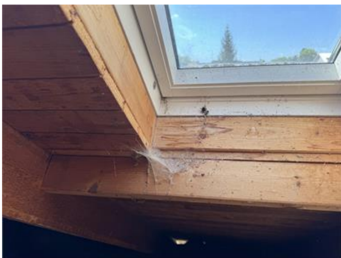
Fuktfläck vid takfönster pånockvind.
