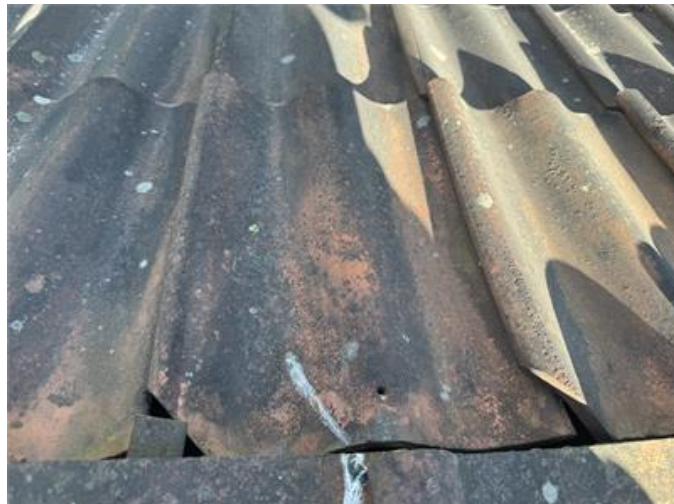
Otättheter som förekommer mellannockpannor och översta pannraden.
