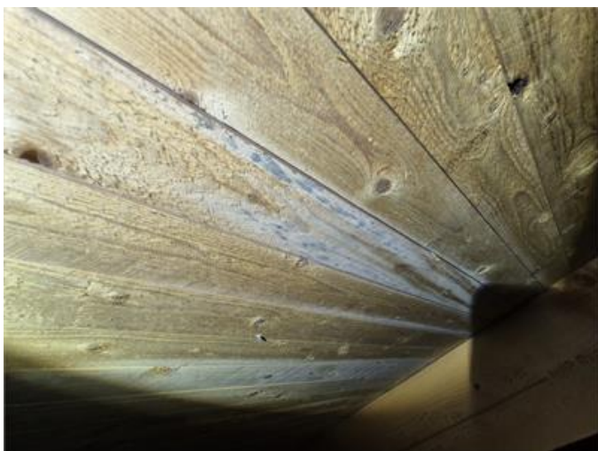
Mindre mängd påväxt noterades på garagets vind.
