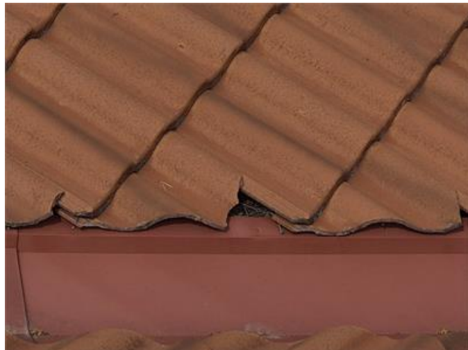
Bild på trasiga takpannor på yttertaket.
