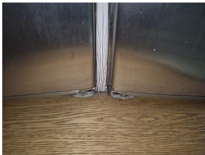
Bild på äldre skada vid kyl/frys
