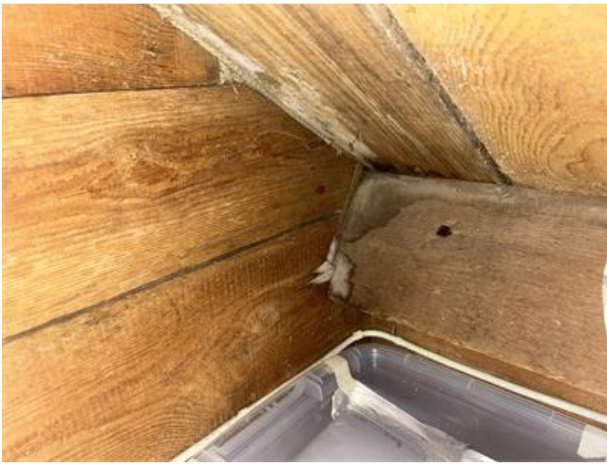
Sidovind: Fuktanvisning på underlagstak.
