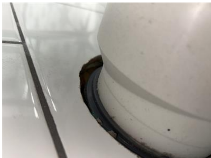
Bad/Wc övervakning: Hål bakom wc-stol samt ej synligt tätskikt.
