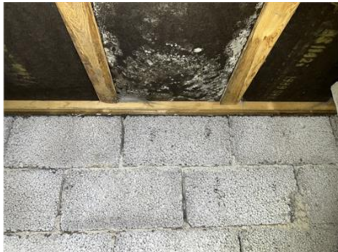
Krypgrund Västdel: Mikrobiell påväxt på blindbottenskvivor.
