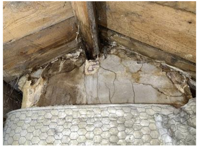
Nockvind: Fuktanvisning på murstock samt sprickor.
