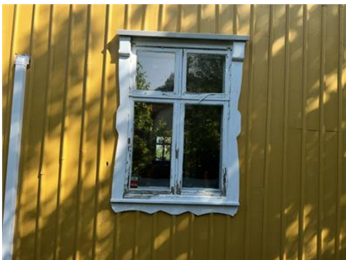
Fönster: Flertal fönster behöver ses över.
