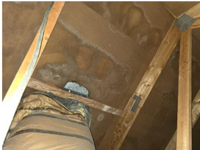
Exempel på fuktfläckar i underlagstak.
