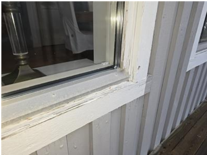
Exempel på fönster utan fönsterbleck och med underhållsbehov.
