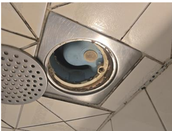
Äldre ej utbytt golvbrunn och äldre plastmatta som ansluter mot denna. (under klinker)
