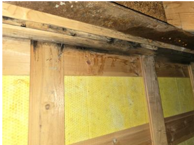
Exempel på rinnmärken och droppar/fuktmärken på del av vind och stålbalk.
