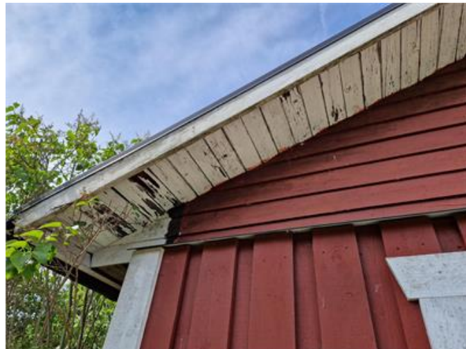
Garage: Skador noterades i takfot.
