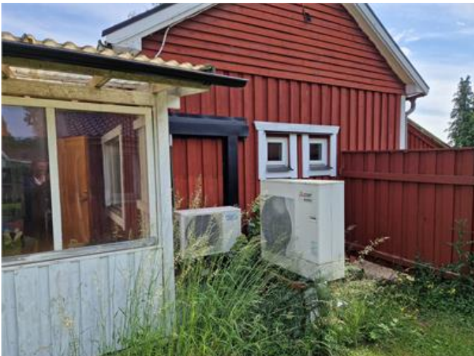
Hängrännor och Stuprör: Hängränna på altantak saknar stuprör.
