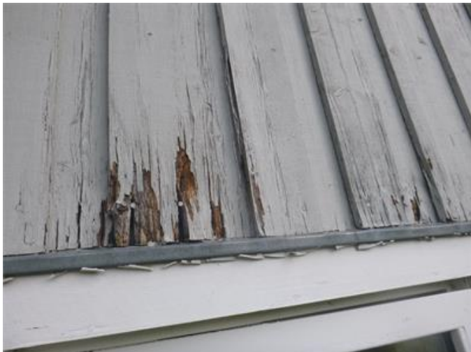
Bilden visar exempel på rötskador i fasadpanelen.
