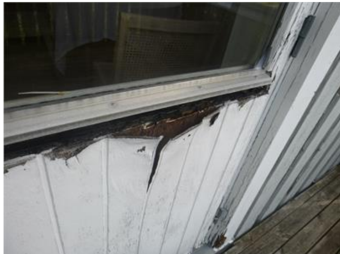
Bilden visar exempel på rötskadad dörr.
