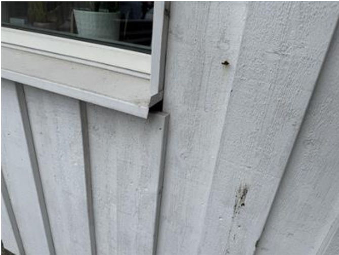
Otättheter i fasad vid fönsterbleck.
