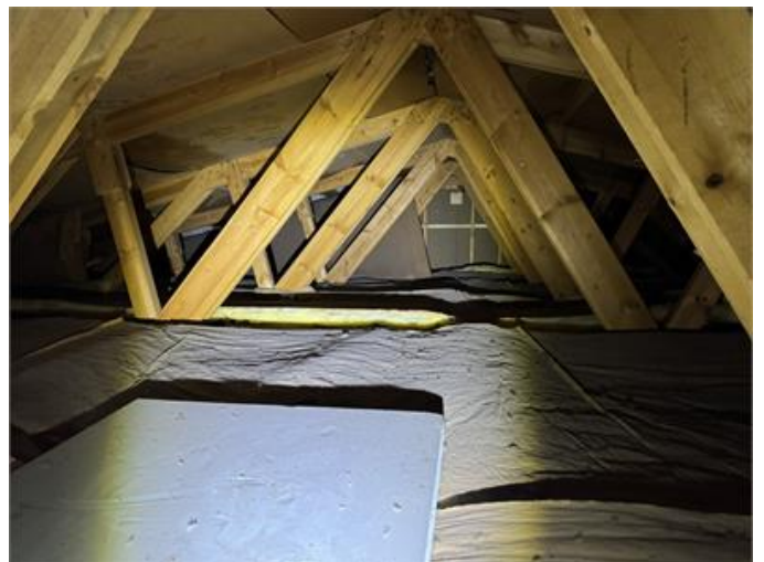
Nedfallna masonitskivor i vindsutrymme.
