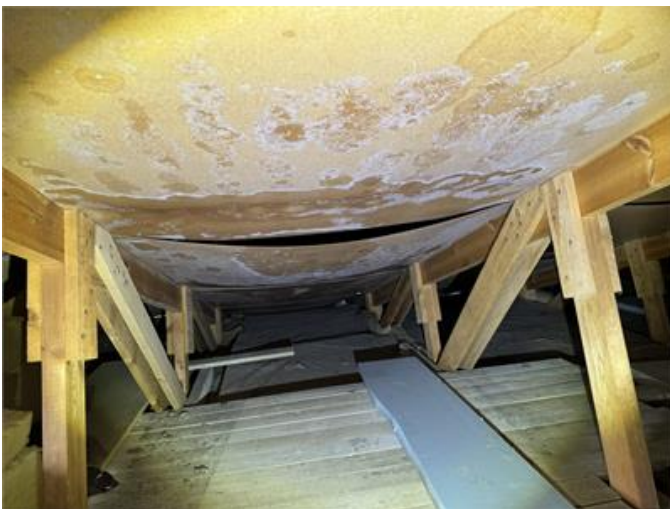
Fuktfläckar/mikrobiell påväxt på underlagstak av masonitskivor i vindsutrymme.
