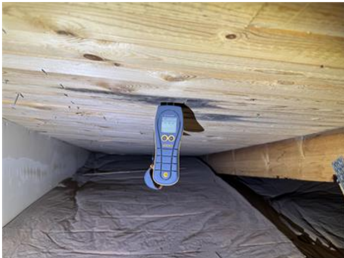
Fuktrelaterad missfärgning på vindens underlagstak.
