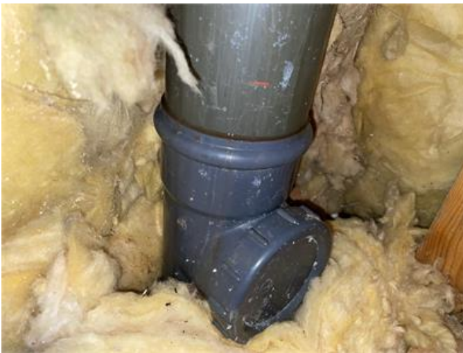
Fukt/läckage runt avloppsstam i slits noteras i bastu.
