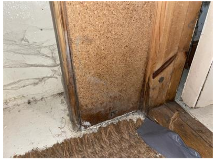
Fuktmärken och missfärgning noteras på trä och organiskt material i dess nederkant källarplan.
