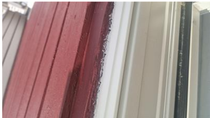
Bilden visar fönsterkarm som är otät mot fasadpanel
