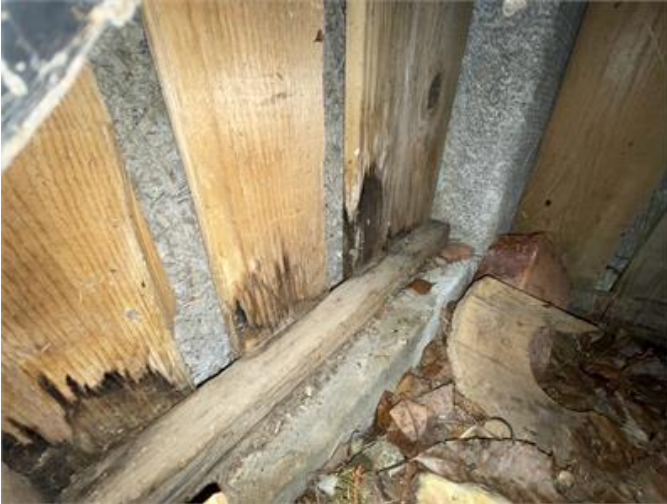
Rötskador och mikrobiell påväxt noteras på trä insida sockel. Grunden igenbyggd mellan plintar.
