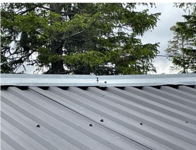
Enstaka lösa plåtdetaljer och skruvar noteras på tak.
