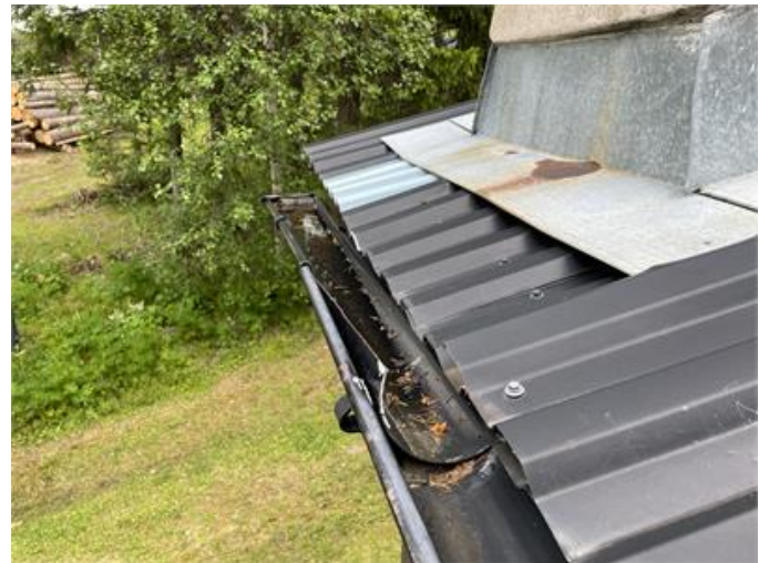
Hängrännor har bristfällig lutning och är i behov av rensning.
