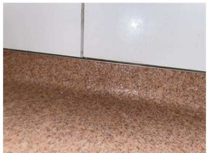
Brister i montering av träfiberbaserade våtrumskivor noteras i dess nederkant.
