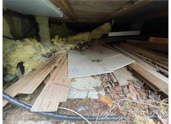
Byggspill och trärester förekommer på marken i grunden och kondensskydd saknas.
