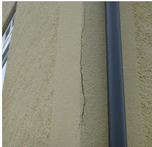
Spricka i fasad av puts
