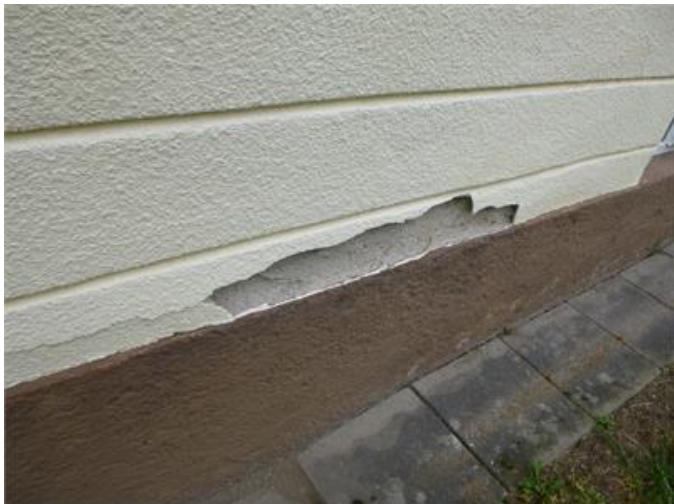
Putsskada mot baksidan
