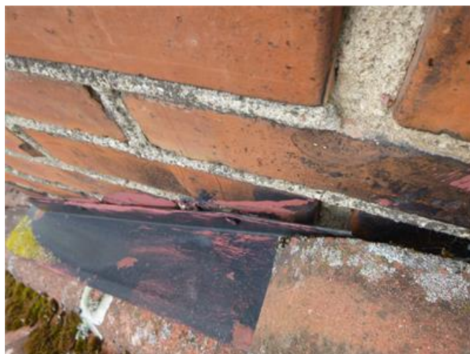
Glipande plåt mellan skorsten och murstock
