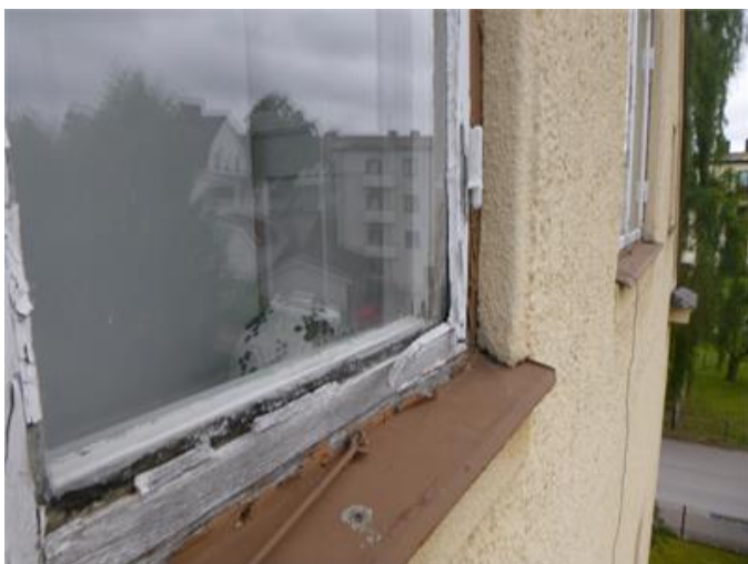
Fönster med eftersatt underhåll
