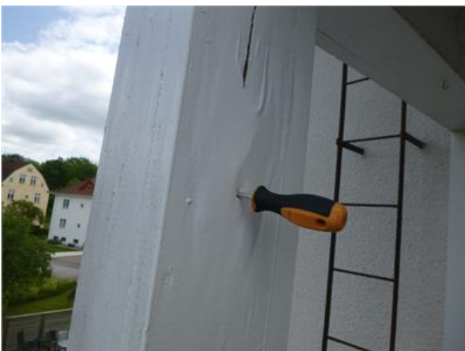
Kraftiga rötskador i balkongens stolpe
