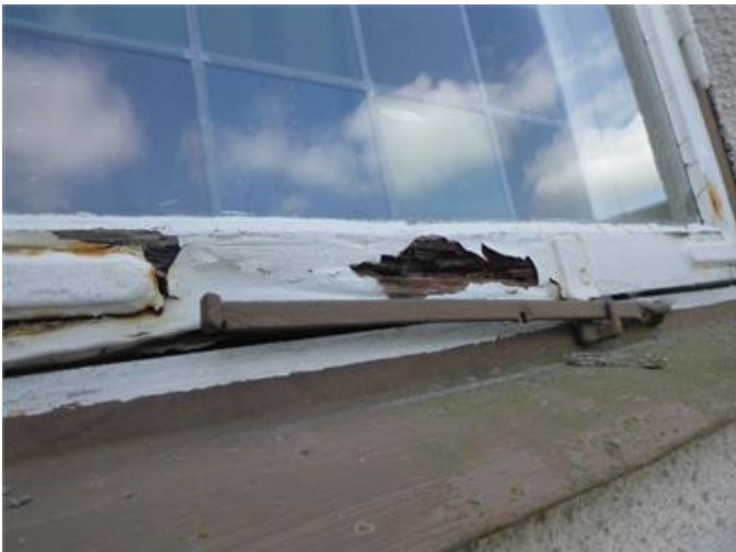
Rötskadad fönster på entréplan
