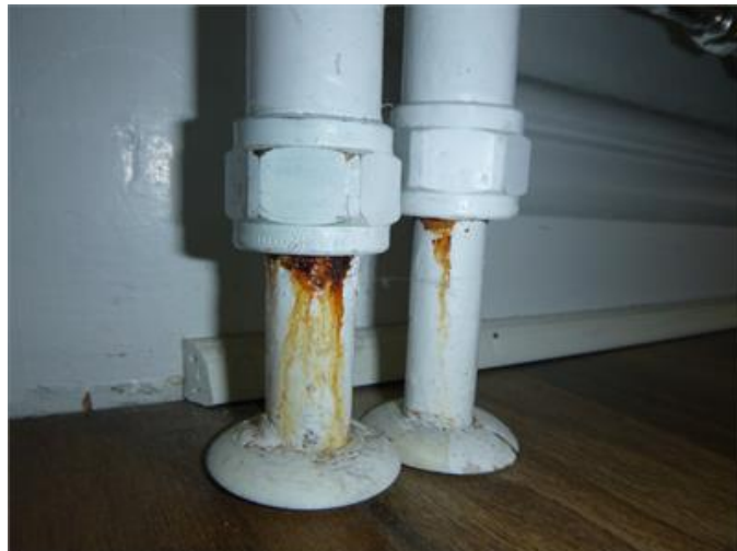
Korrosion i radiatorrör i lägenhet 1
