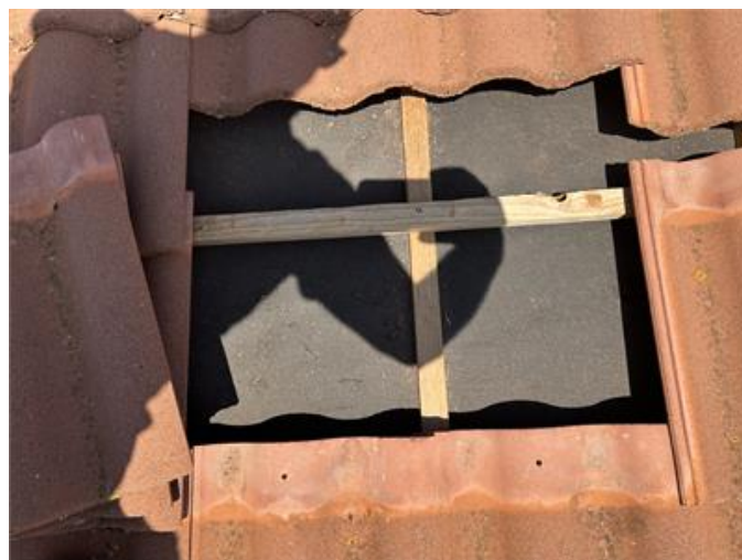
Tak: Stickkontroll utan anmärkning.
