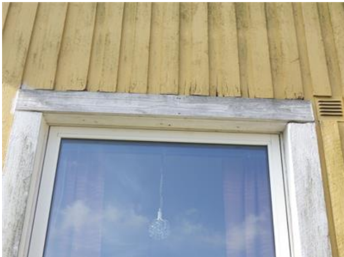
Finns ej överbleck , rötskador.
