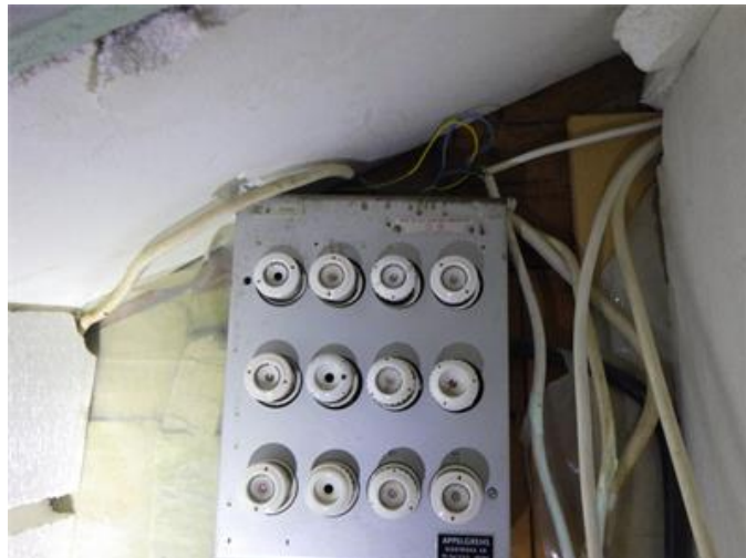
Enkelisolerade ej fast monterade elkablar.
