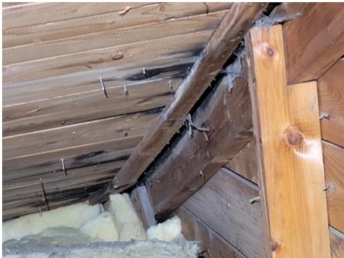
Fuktfäckar/missfärgningar på underlagstak
