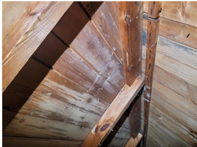
Mikrobiell påväxt på underlagstak och vägg.
