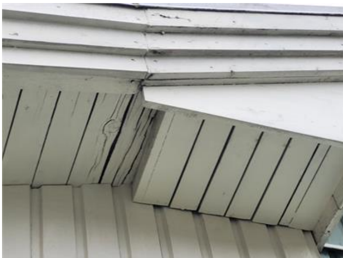
Rötskada i taksprong.
