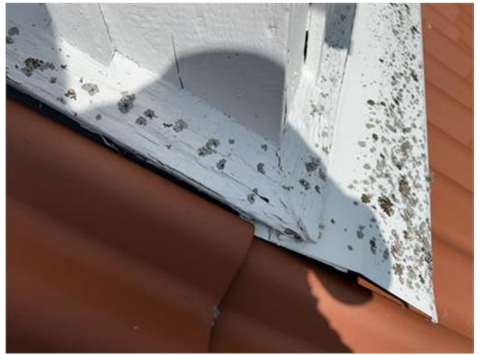
Fasad: Rötskadad ståndskiva.
