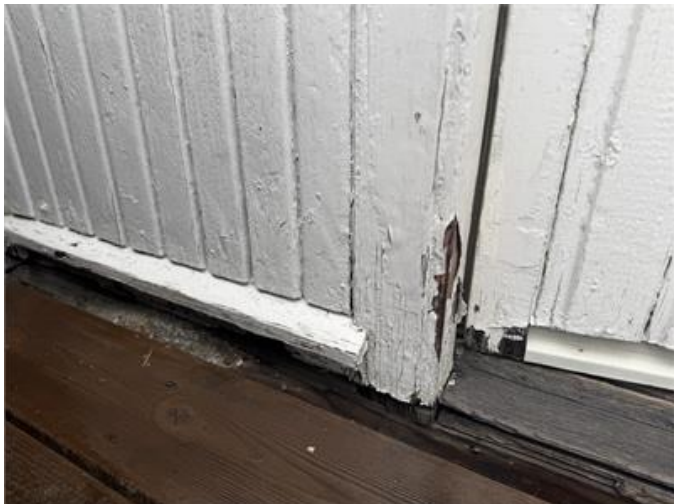
Träkonstruktion invid balkongdörr som är fuktutsatt.
