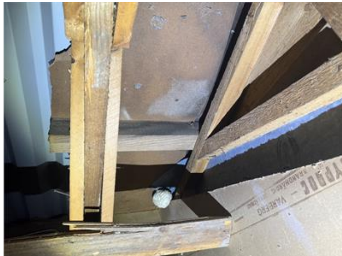
Bild visar missfärgningar på underlagstak samt synligt undertak av plåt.
