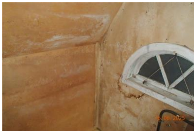
Äldre fuktskada noterades i ena sidovinden
