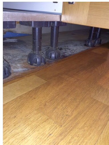
Skadat parkettgolv under köksskåpet
