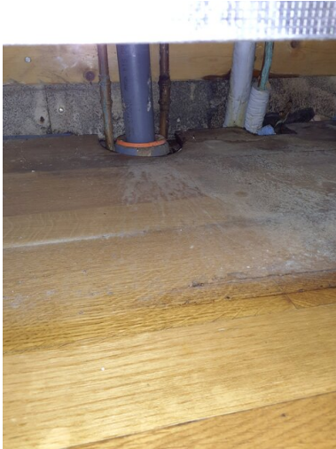
Mikrobiella påväxter på gipsvägg samt skadat parkettgolv
