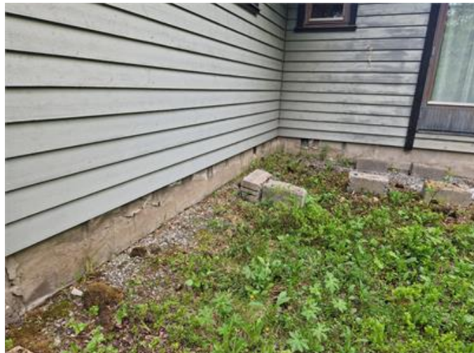
Fuktuppsug samt puts släpp noteras.
