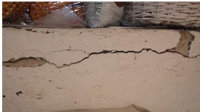
Spricka i källarvägg
