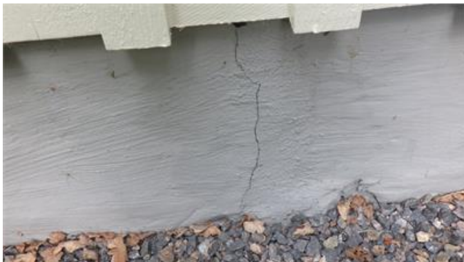
Spricka i sockeln
