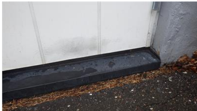
Källardörr med målning/underhållsbehov
