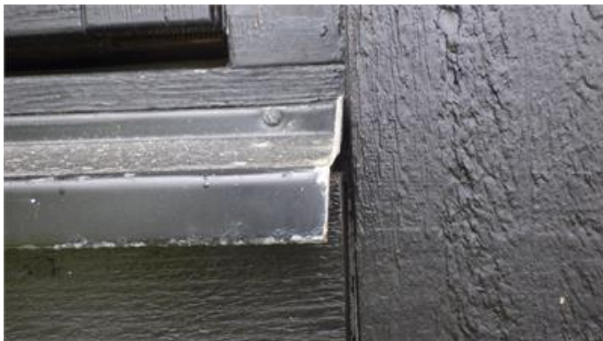
Otät infästning av fönsterbleck
