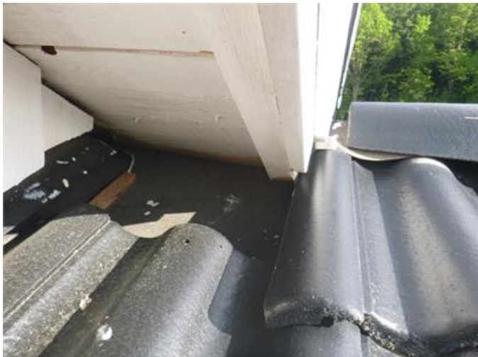
Bilden visar del av tak där panna/plåt saknas.
