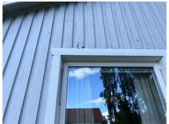
Fasad: Rötskador samt finns inget överbleck på flera fönster.
