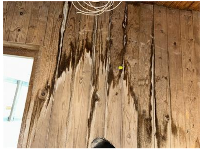
Nockvind: Fuktanvisning på landgång.
