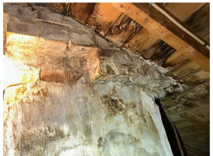
Nockvind: Fuktanvisning samt mikrobiell påväxt noteras.
