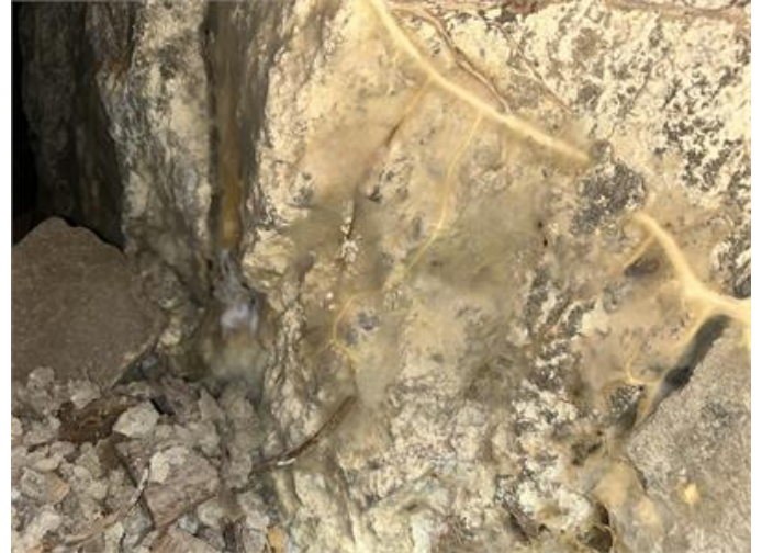
Krypgrund: Mikrobiell påväxt noteras på marken.
