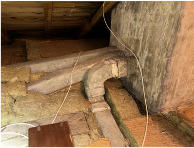
Nockvind: Eternitrör oisolerade på vinden.
