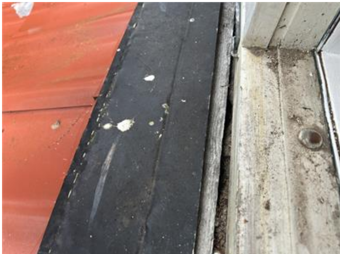
Fönster: Otätheter noteras vid bl.a. trapphall
