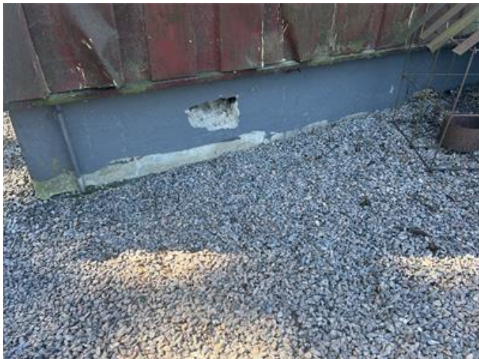
Pos 1. Skada (hål) noterades i grundmur.
