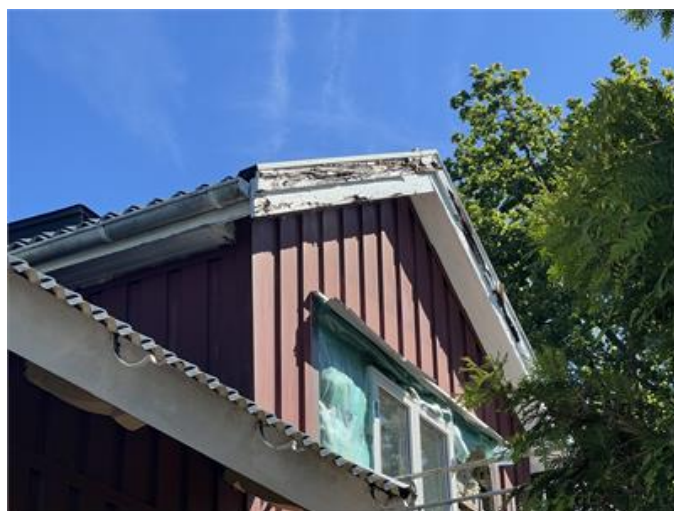
Pos 4. Rötskador förekommer i vindskivor.
