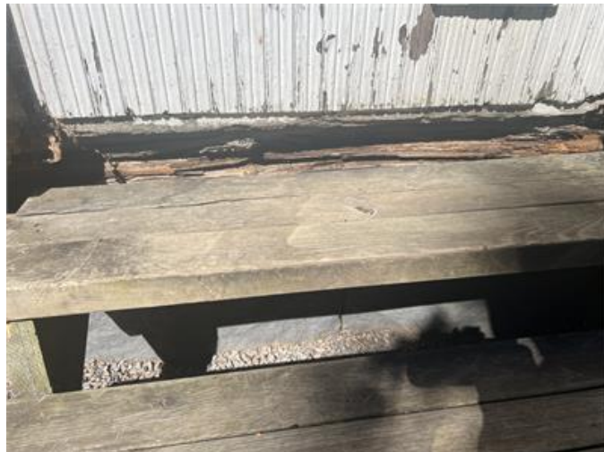
Pos 2. Rötskador förekommer i syllar under dörrar.
