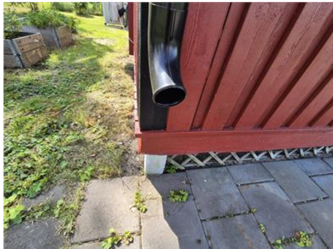
Bild på rötskada i fasaden.
