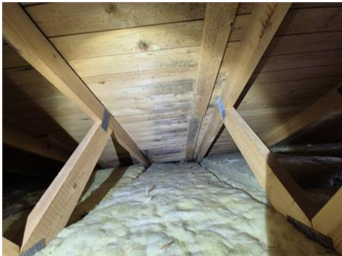
Mikrobiell påväxt på vinden.
