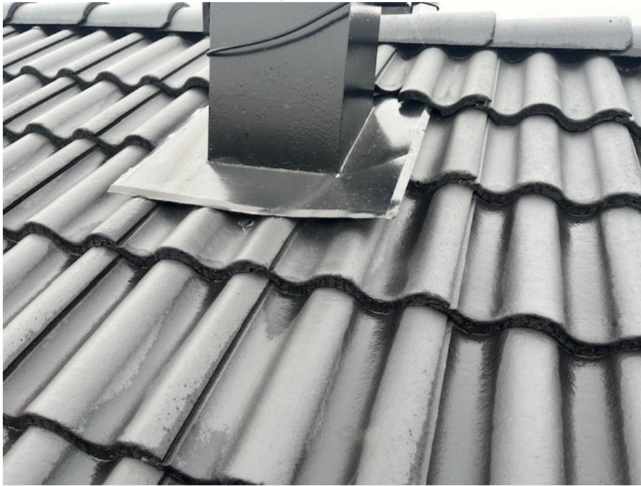
Plåtinklädnad kring takfläkt som tätar/täcker något bristfälligt.
