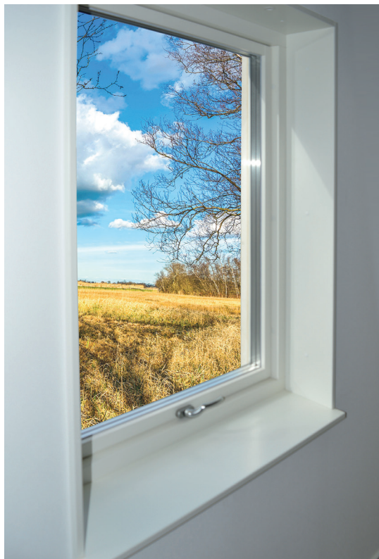
FODERBILDANDE FÖNSTERMYG OCH FÖNSTERBRÄDA I MDF.
