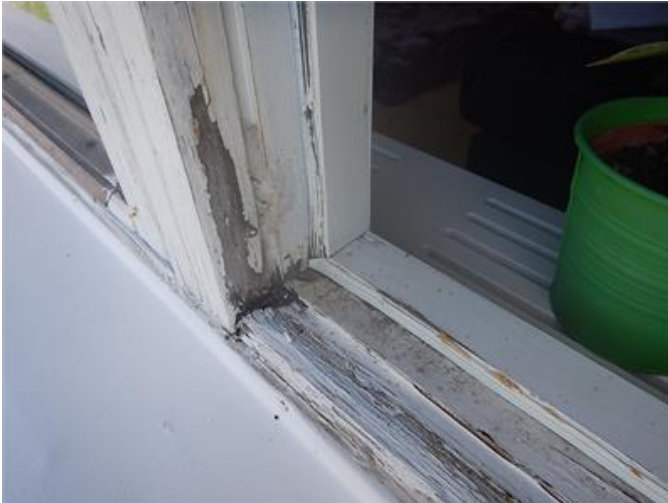
Fönster: Fönster har bristfälligt underhåll och några är rötskadade.
