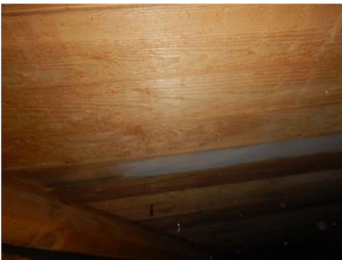
Nockvind: Mikrobiell påväxt noterades lokalt på underlagstaket i takkupa.
