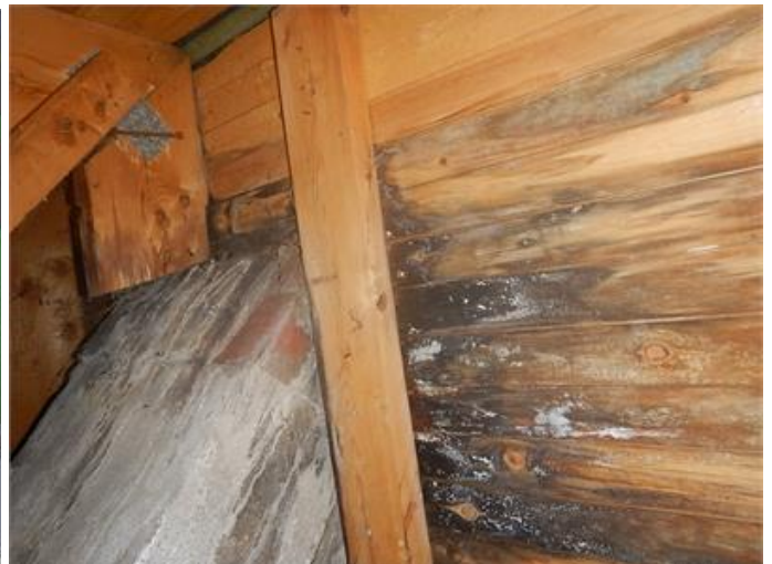
Nockvind: Missfärgning och lokalt rötskadat underlagstak runt murstock. Fuktindikering utförd utan anmärkning.
