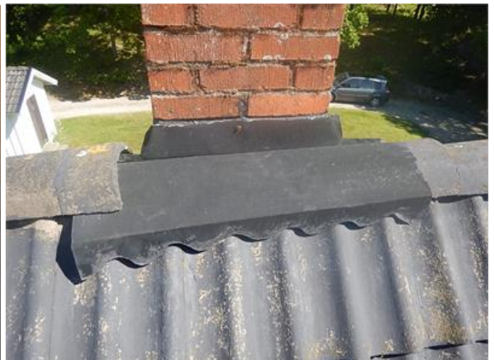
Tak: Takbeklädnaden har nått sin beräknade tekniska livslängd. Underlagspappen är torr, sprickor kan förekomma. Läckage in på underlagstak har skett över tid vid murstock.
