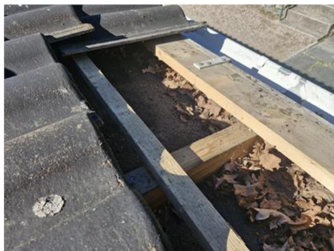
Tak, vid takfot entredel samlas löv under pannorna och avrinningsmöjlighet finns ej.
