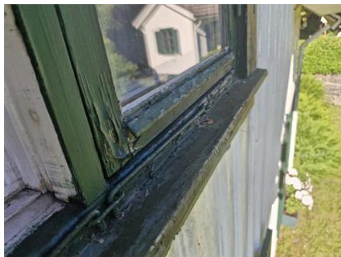
Fönster, underhållsbehov och delvis byte.
