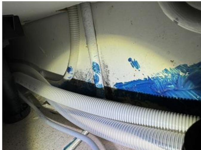
Missfärgningar på gipsskiva i diskbänksskåp.
