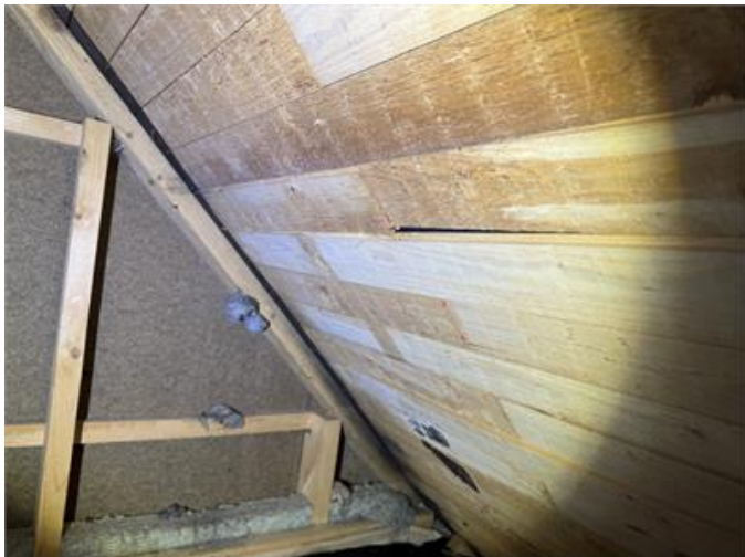
Mikrobiell påväxt på vindens underlagstak som troligen är från byggnation.
