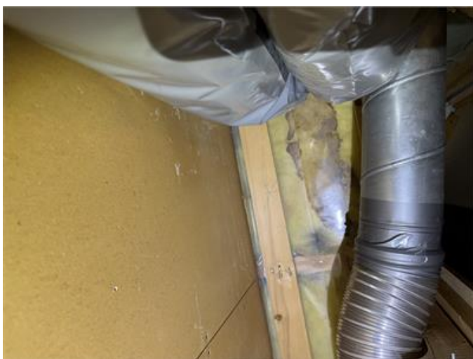
Missfärgning på ovansida plastfolie ovan ventilationsaggregat.
