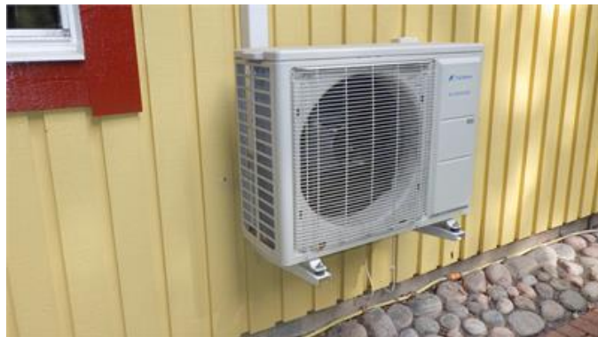
Värmepumpens utomhusdel vid fasaden
