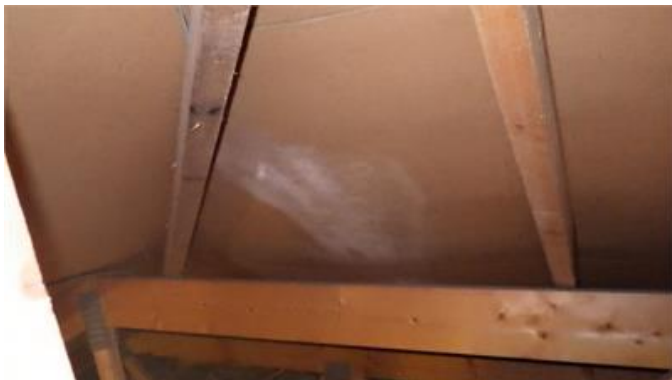
Fuktfläck på insida yttertaket på vinden
