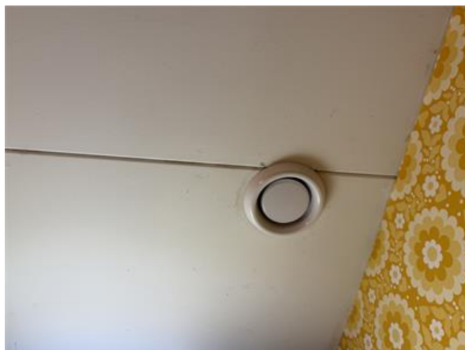
Missfärgning/fuktfläck i tak invid ventilation i tvättstuga
