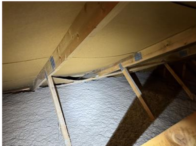
Träfiberskiva på vind som har lossnat
