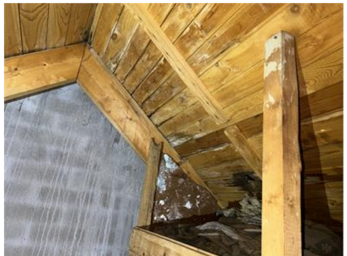
Nockvind: Mikrobiellt samt fuktfläckar noteras.
