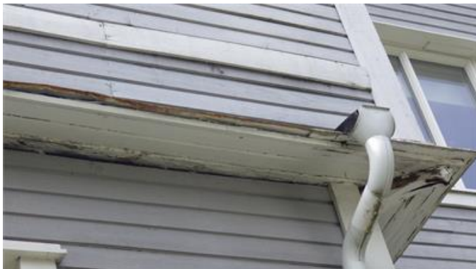
Rötskada i balkong
