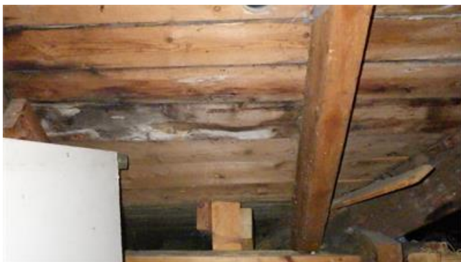
Fuktfläck på insida yttertaket på vinden
