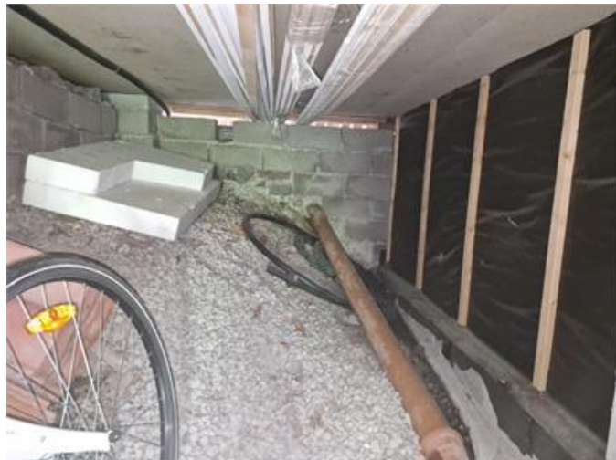
Krypgrund utbyggnad baksidan, mindre mängd vatten rinner in.
