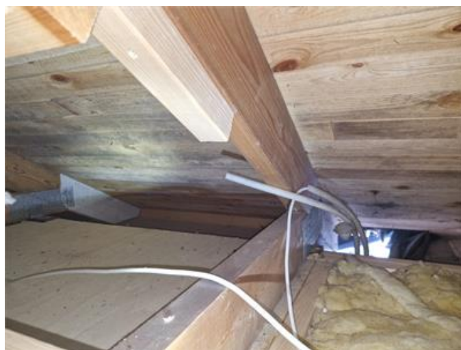
Sldovind Loft söder, viss mikrobiell påväxt i underlagstaket, större öppning utan insektsnät.
