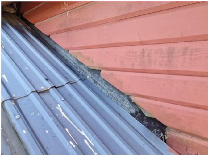
Tak: Bristfällig anslutning mellan tak och fasad.
