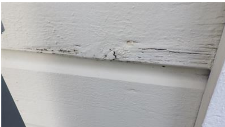
Rötskada i fasaden
