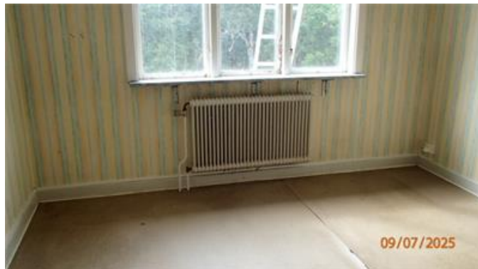
Fuktmärken under fönster på sovrum på övre plan
