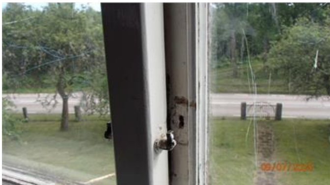
Skadade Fönster. Kunde ej stängas
