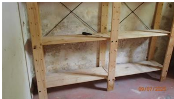
Putssläpp och saltutfällningar noterades på källarväggar
