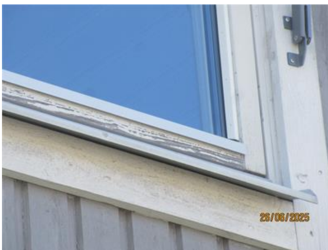
Fönster i underhållsbehov.
