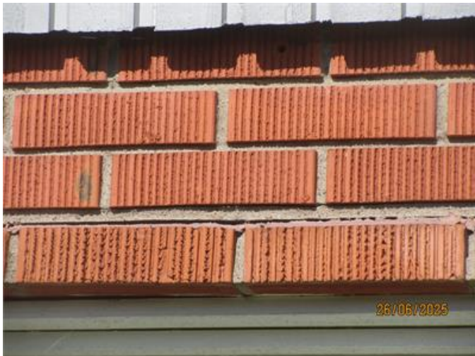
Sprickor förekommer i tegelfasaden.
