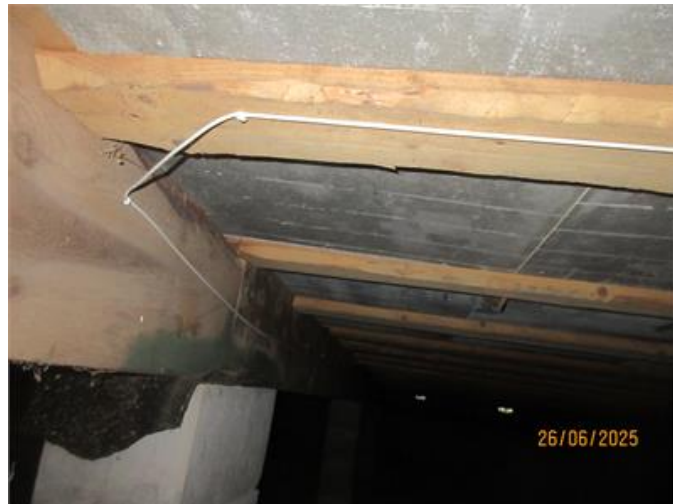
Blindbotten av eternitskivor, notera att dessa kan innehålla asbest
